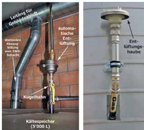
Bild 7: Kugelhahn mit Abzweig (Beprobung, manuelle Entlüftung) und automatische Entlüftung (links). Das abgeschiedene Gas aus dem primären Kreislauf (Kältespeicher) wird in einer Edelstahlleitung direkt zum Dach geführt (rechts).
