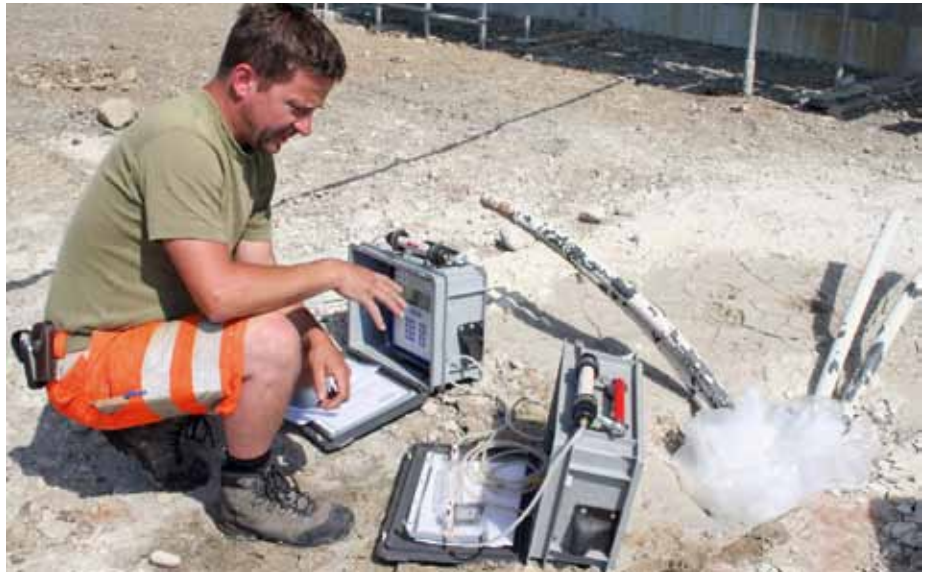
Bild 3: Beprobung des aus der Erdwärmesonde No. 20 ausströmenden Erdgases. Eine unmittelbar vor Ort durchgeführte erste Messung ergab einen Methananteil von über 91%.
