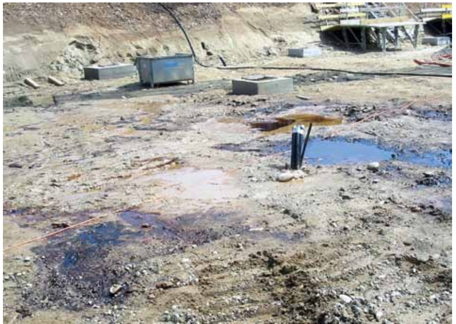
Bild 2: Kohlenwasserstoffaustritte (Erdöl) während der Erstellung des Geothermiefeldes der Blumenbörse Rothrist. 2005 wurden in 70, 142 und 154 m Tiefe kleinere Erdöleintritte beobachtet. Das Geothermiefeld befindet sich heute unter dem Fundament der Blumenbörse.
