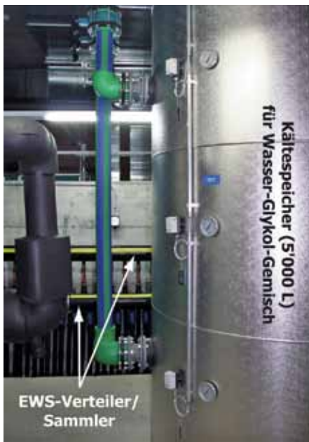
Bild 4: Kältespeicher für den primären EWS-Kreislauf (Volumen: 5000 l). Im Hintergrund ist ein Ausschnitt des EWS-Verteilers/Sammlers zu erkennen.
