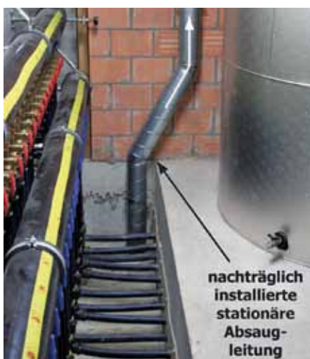
Bild 5: Ansicht des Schachtes, in welchem die einzelnen Erdwärmesonden in das Gebäude geführt werden. Kontrollmessungen ergaben, dass sich hier Erdgas angesammelt hat. Die nachträglich eingebaute stationäre Absaugleitung hat sich als wirksame Maßnahme gegen die Anreicherung von Erdgas erwiesen.
