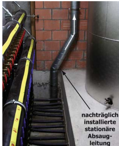
Bild 5: Ansicht des Schachtes, in welchem die einzelnen Erdwärmesonden in das Gebäude geführt werden. Kontrollmessungen ergaben, dass sich hier Erdgas angesammelt hat. Die nachträglich eingebaute stationäre Absaugleitung hat sich als wirksame Massnahme gegen die Anreicherung von Erdgas erwiesen.
