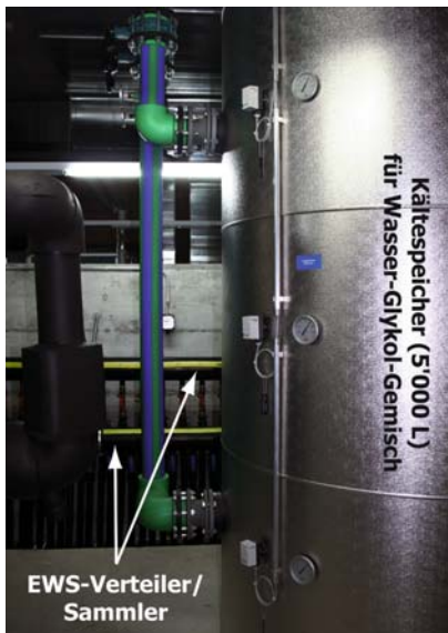
Bild 4: Kältespeicher für den primären EWS-Kreislauf (Volumen: 5000 L). Im Hintergrund ist ein Ausschnitt des EWS-Verteilers/Samplers zuerkennen.
