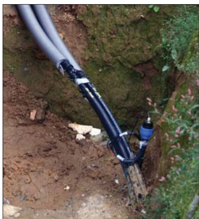
Abb. 2: Bereits teilweise mit Tubolit isolierter Sondenkopf mit eingebautem Temperaturfühler (blaue Verschraubung)
