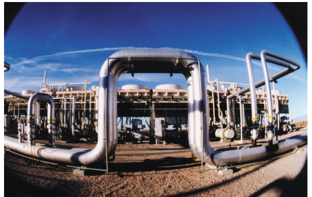
Beispiel einer kleinen geothermischen Anlage von 13 MW elektrisch (Stillwater, Nevada, USA) (Foto JW)
