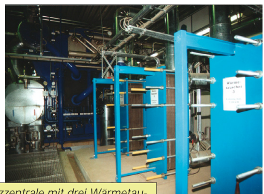
Heizzentrale mit drei Wärmetauschern in Erding (Foto O. Joswig).
