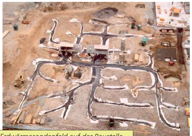
Erdwärmesondenfeld auf der Baustelle der SUVA in Root, Luzern (Foto B. Keller)
