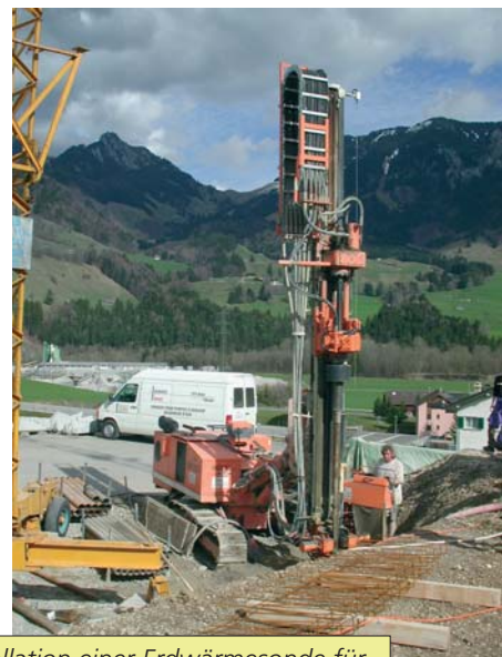
Installation einer Erdwärmesonde für ein Einfamilienhaus in Enney, Fribourg (Foto F.-D. Vuataz)
