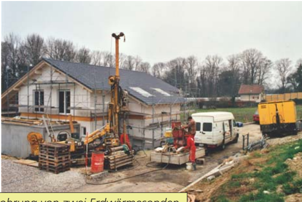
Bohrung von zwei Erdwärmesonden mit je 75 m für ein Minergie-Haus in Bevaix, Neuchâtel (Foto F.-D. Vuataz)
