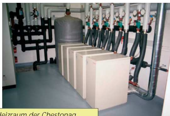
Heizraum der Chestonag Automation AG mit fünf Wärmepumpen à je 14 kW (Foto M. Eberhard)
